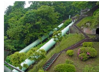
内径 2,150~1,700 の水圧鉄管
